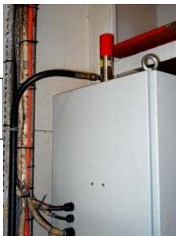
Cabinet cooler εγκατεστημένο σε πίνακα
