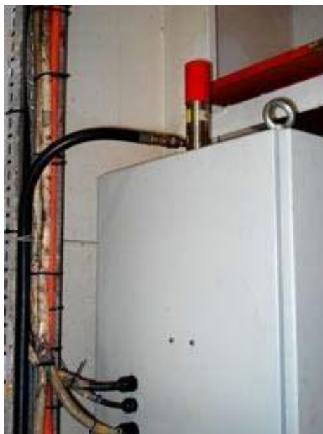
Cabinet Cooler εγκατεστημένο σε πίνακα
