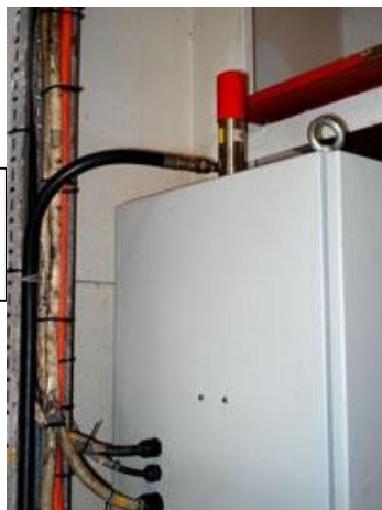
Cabinet cooler εγκατεστημένο σε πίνακα
